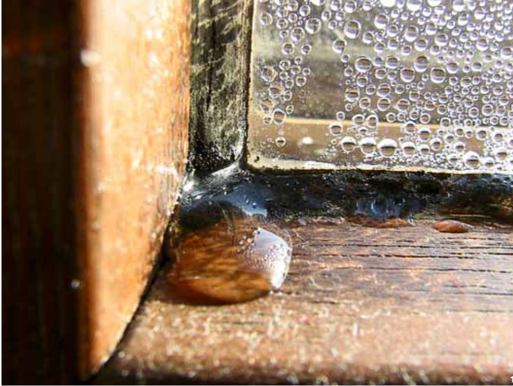
1 Kondenswasser im Fensterbereich wurde in letzter Zeit verstärkt zum Problem.
